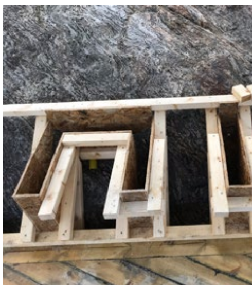
Vid gjutning mot ett ojämnt underlag formsågas formen så att den följer underlaget.
