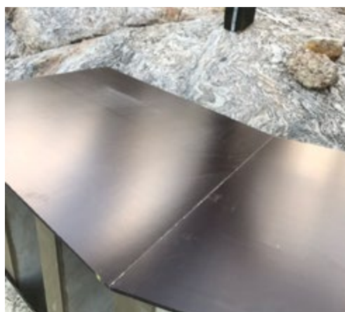
Fastställ måtten på bänkskivorna genom att lägga bottenarna mot varandra, innan formen sätts samman.
